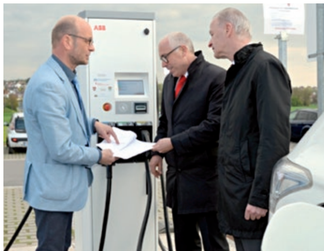
Die neue Schnellladesäule für Elektrofahrzeuge in Bad Neustadt hat ihren ersten Stress-Test bravourös bestanden. Stolz auf die neue Serviceeinrichtung sind (von links): Ulrich Leber, Projektmanager Elektromobilität und Technischer Werkleiter der Stadtwerke Bad Neustadt, Georg Straub, Sparkasse Bad Neustadt und Reiner Türk, Volks- und Raiffeisen-Bank Rhön-Grabfeld. Foto Tonya Schulz
