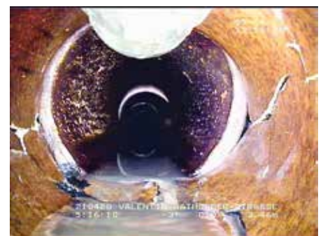
Foto: Schäden der Kanäle Quelle: Abwasserverband Saale-Lauer
