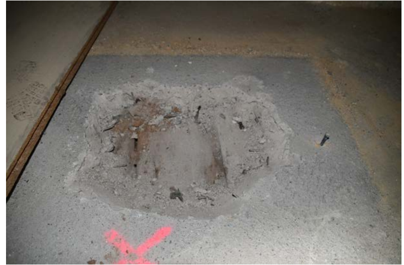
SCHADENSERFASSUNG - SCHÄDEN IM BEREICH TRAUFE
